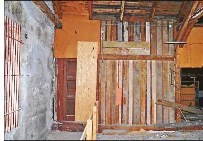
Hier, im Dachverschlag des Concerthauses versteckte sich 1943 die Jüdin Erna Hirche, geb. Schiff, die den Holocaust überlebte.
